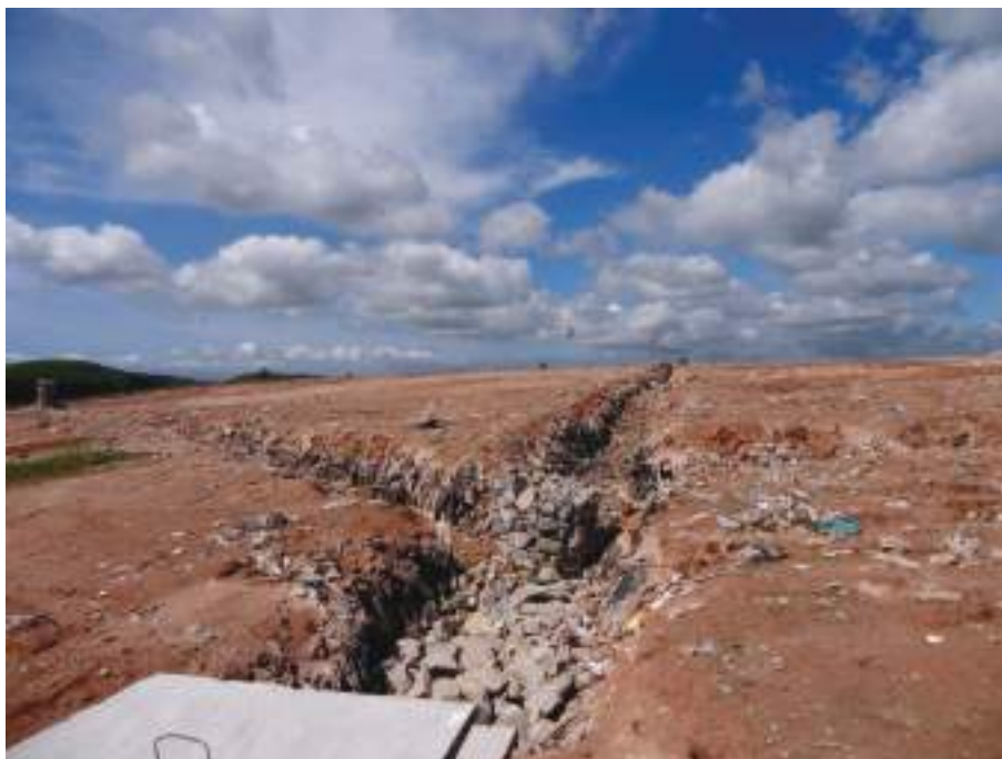
Figura 79: Aterro Controlado Bongaba – Drenagem de gases – Magé (dez/2012).
