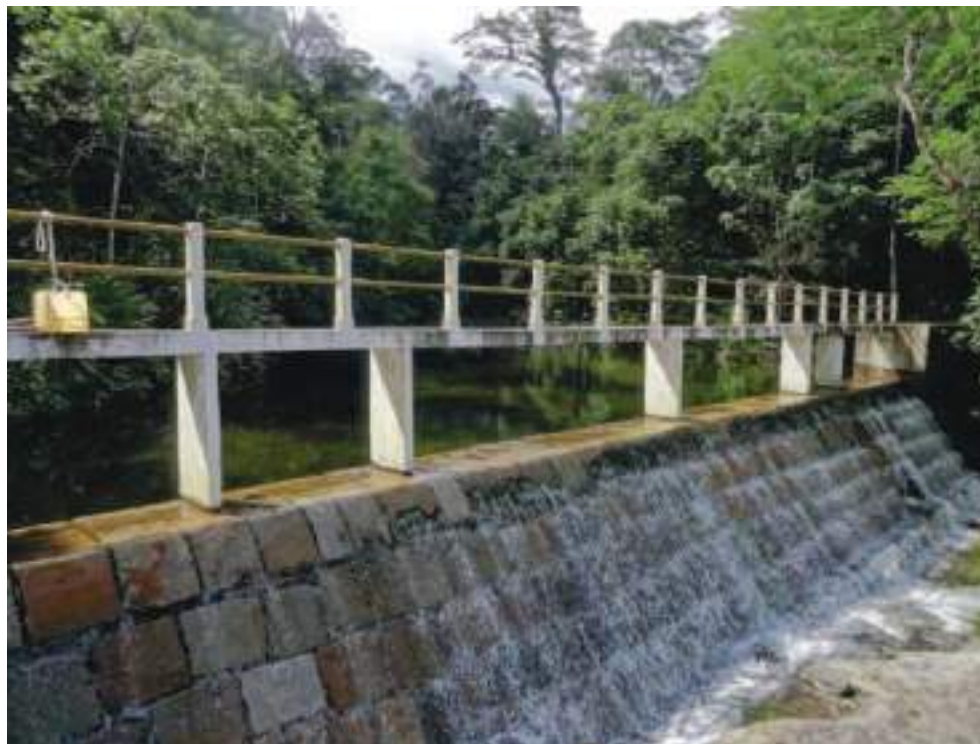
Figura 15: Barragem – Sistema Paraíso CEDAE
