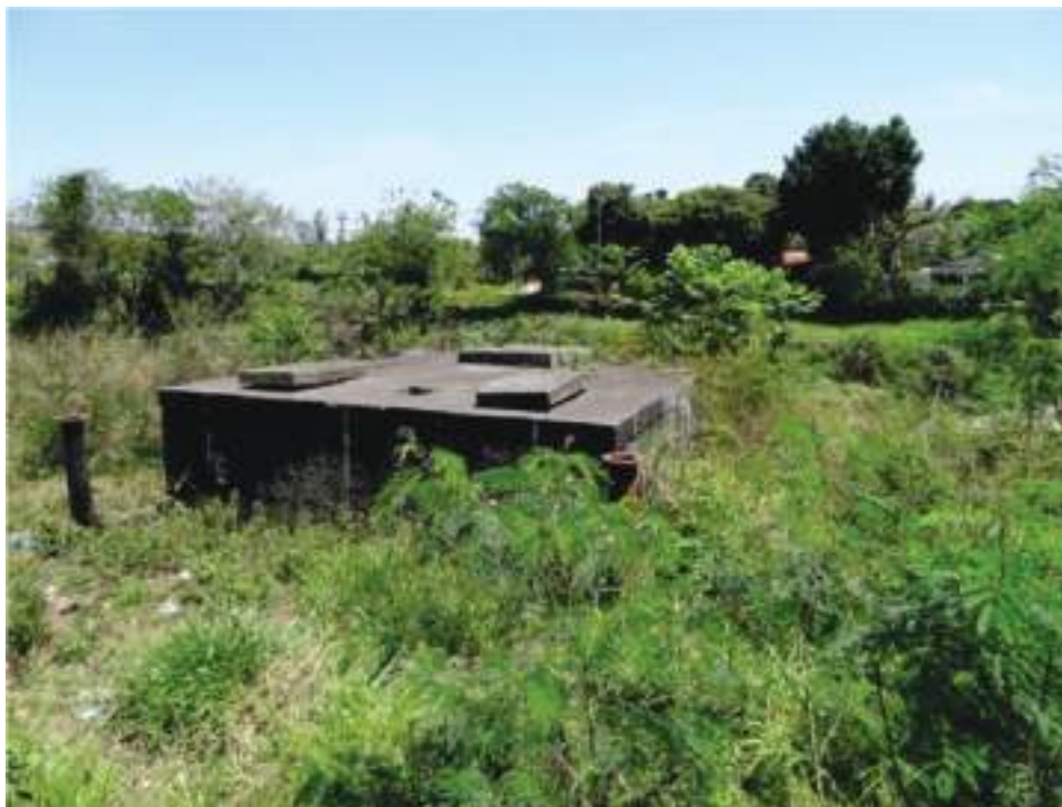
Figura 31: Caixa de Tomada d'água (inativa) da captação Rio Roncador – CEDAE
