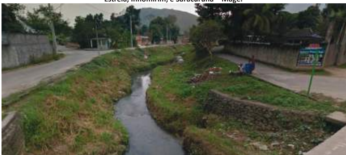
Figura 64: Ponte sobre afluente do Rio Imbariê, em processo erosivo por perda de mata ciliar – Parque Caçula – UP1 - Bacia dos Rios Estrela, Inhomirim e Saracuruna – Magé.
