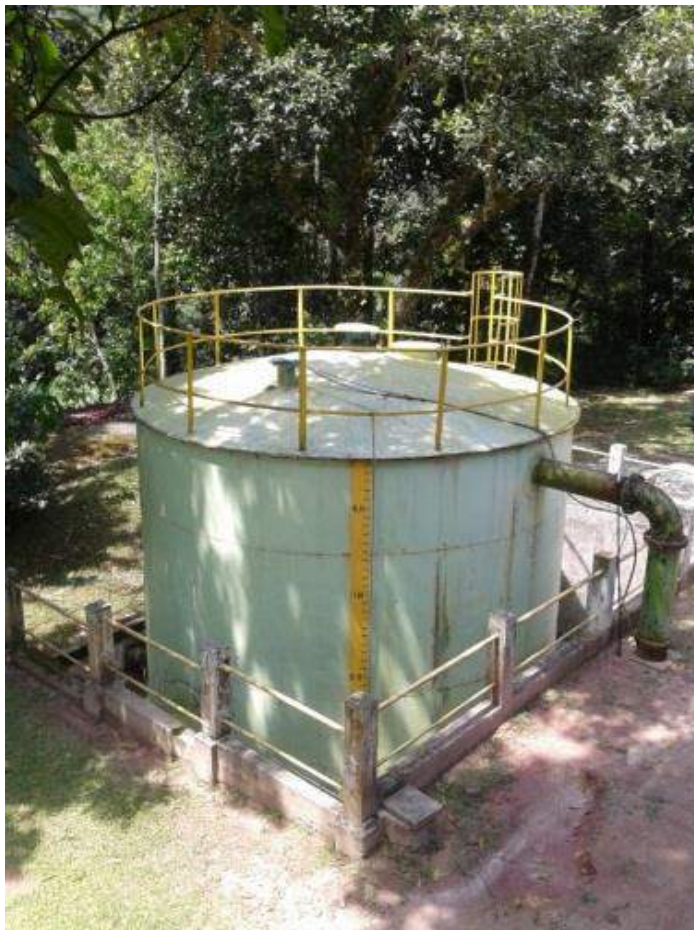
Figura 16: ETA Sistema Rio Soberbo – Tanque de contato e reservatório (100.000l)
