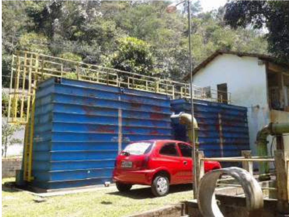
Figura 14: ETA Sistema Rio Soberbo – vista lateral dos filtros.
